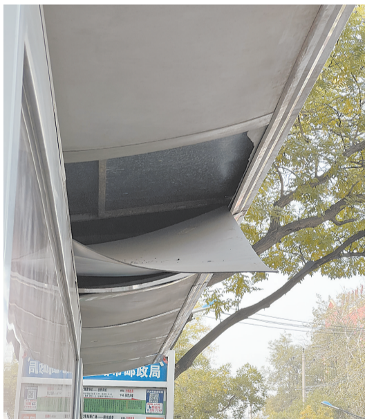
近日在裕华路市邮政局对面等公交车,一抬头发现车站顶棚有一处快掉下来了,很危险。 张洁菲 摄
