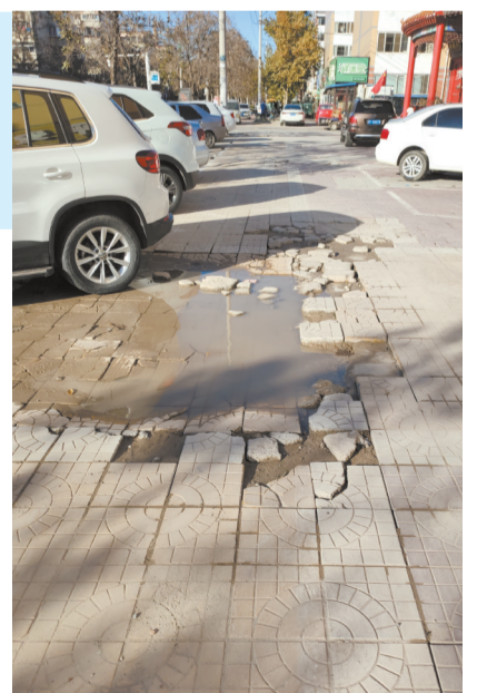
▲李庄街和城苑路交叉口北,两侧便道破损严重。
