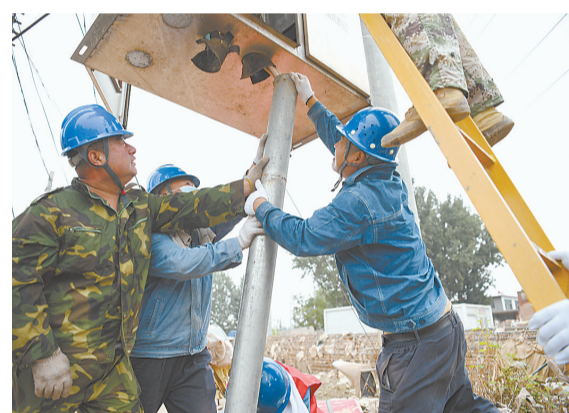
国网河北电力公司调集各地电力应急抢修队伍驰援涿州,抢修因灾受损电力设施。
