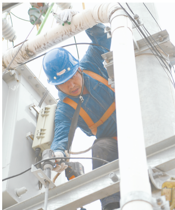
邯郸供电公司抢修人员在涿州市码头镇向一村更换JP柜。
