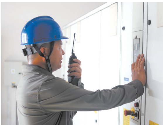
设备维护科人员及时发现高压配电柜组安全隐患并及时抢修。
