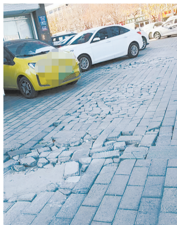
中央峰景商铺前面的地砖破损严重, 希望可以修复一下。 晓东 摄
