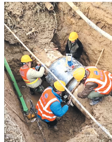
供水公司成功修复三丰路与史庄街口东侧绿化带内DN600水泥供水管道。 供水公司供图
