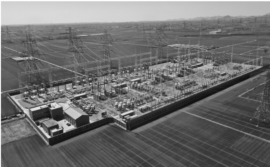
在定兴县,雄安1000千伏特高压变电站扩建工程投运,满足雄安新区高质量建设发展用电需求。 黄烁 摄
