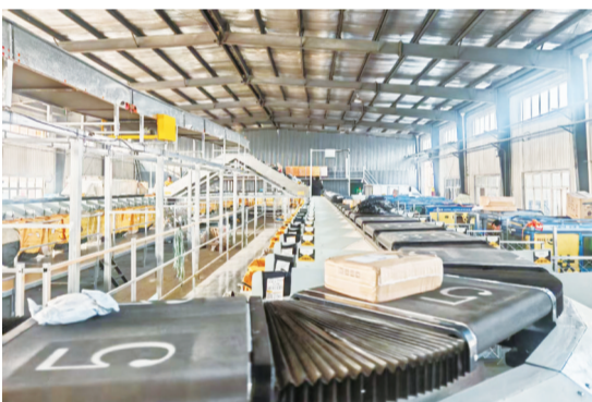
快递配送中心全自动环形分拣机正在作业。
